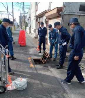
スタンドパイプは公園外の道路上に取水口があります
